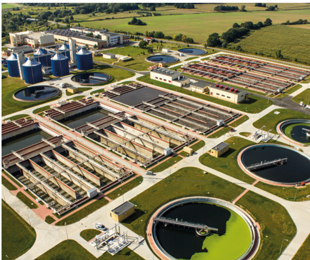
Wrocławska oczyszczalnia ścieków
